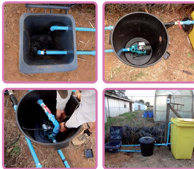
Figura 4.5. Sistema de recirculación
